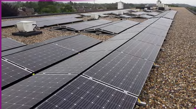
Zonnepanelen Ave Maria
